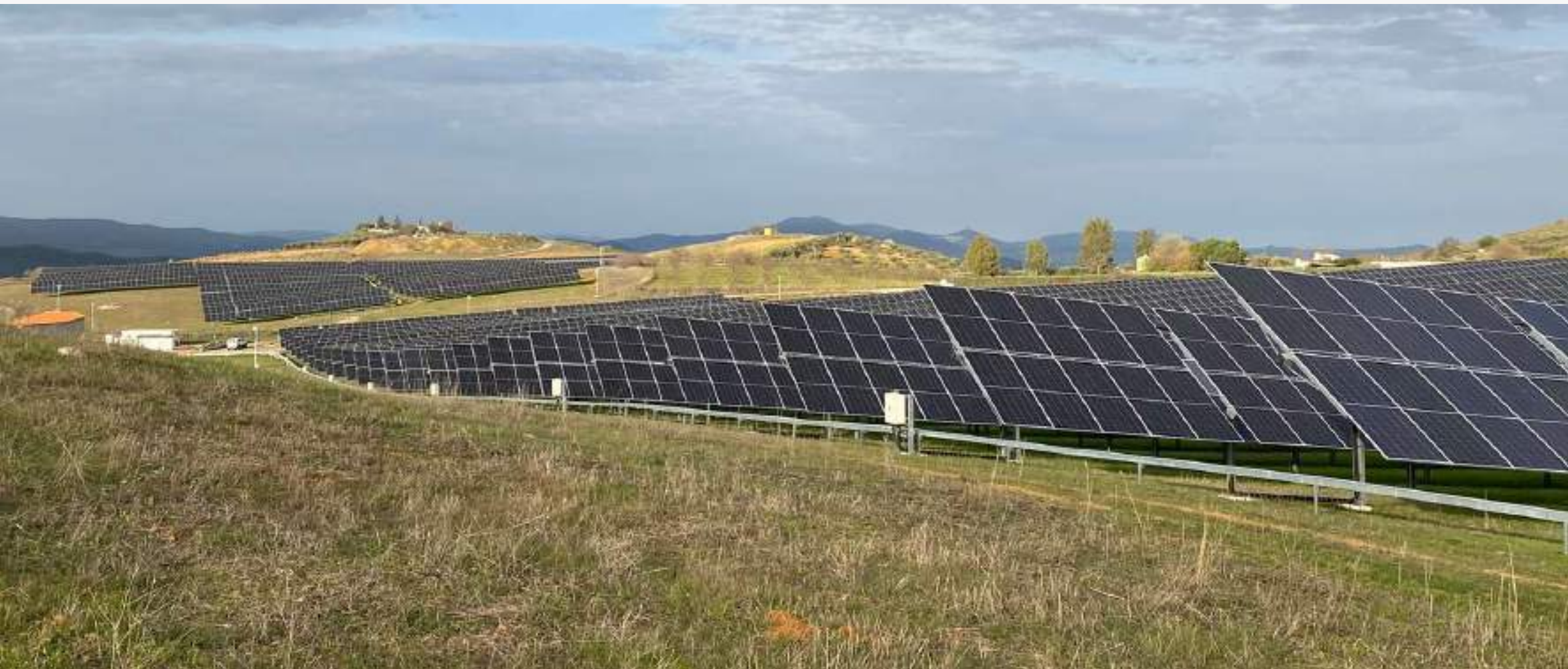
Planta solar Zafra
